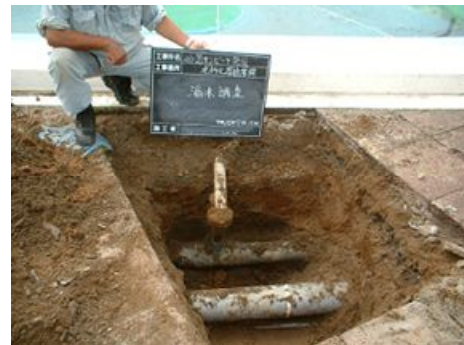
■プール ・循環配管
