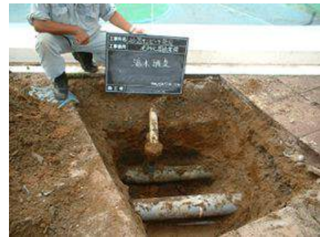
■プール ・循環配管
